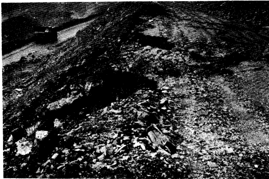
Foto 7. Corta Sabero Ocho.- Borde exterior de la berma de uno de los bancos inestables. Talud N.
