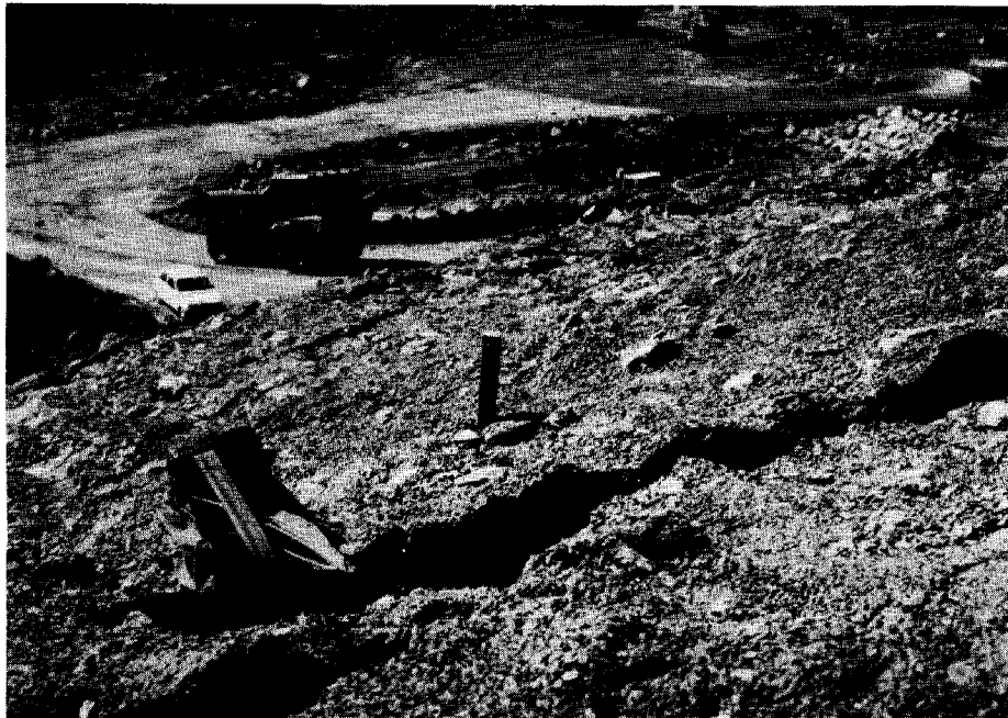
Foto 28. Corta Cervantes.- Grietas producidas en el talud N de la corta a favor de discontinuidades con dirección paralela al talud y buzamientos subverticales.
